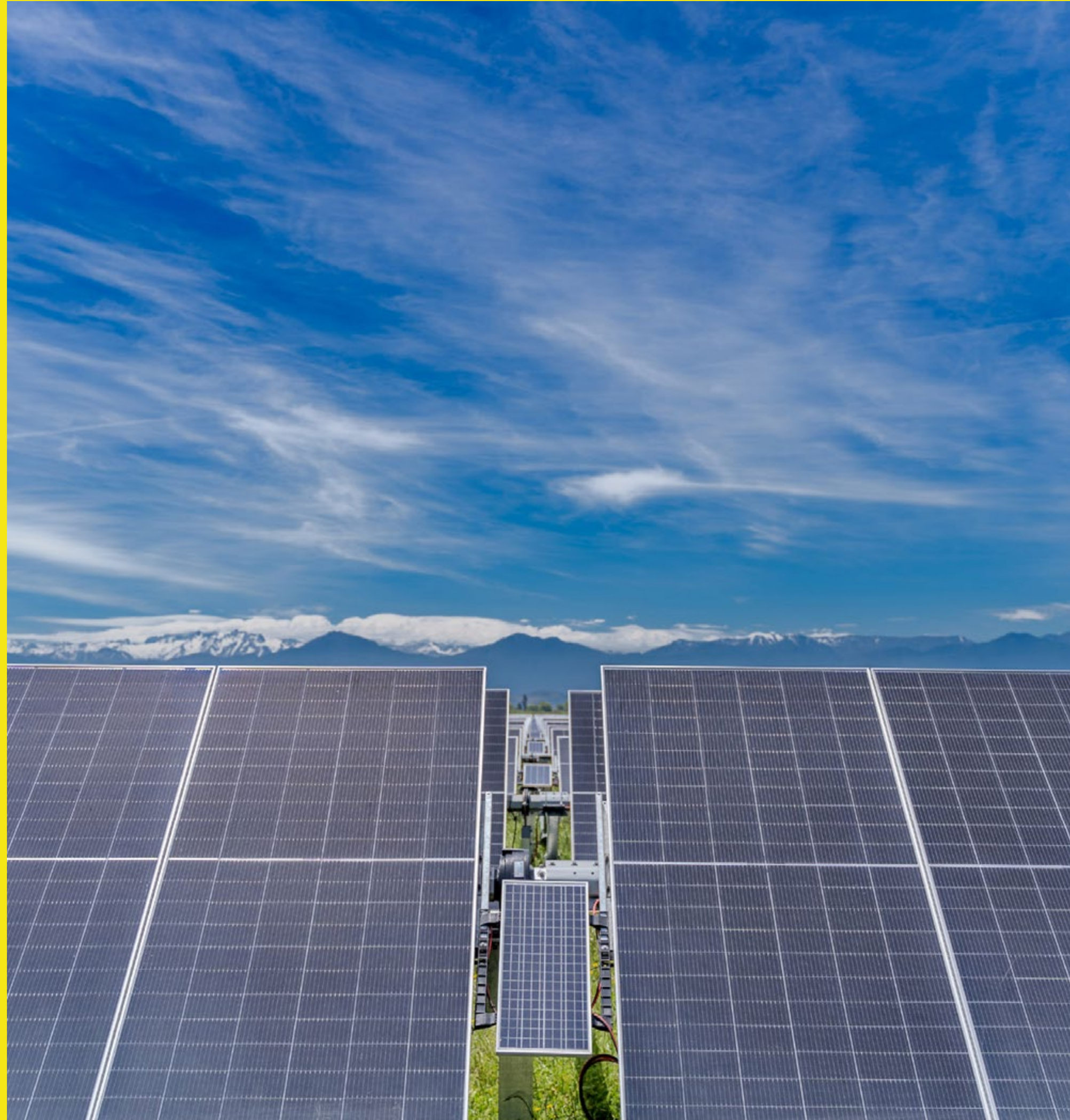
Gran Teno 200 MW PV plant, Chile
