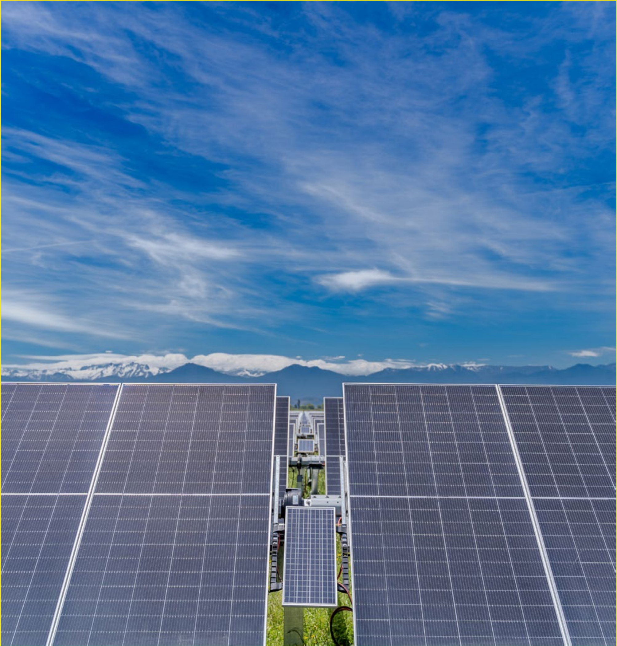
Planta FV Gran Teno 200 MW, Chile
