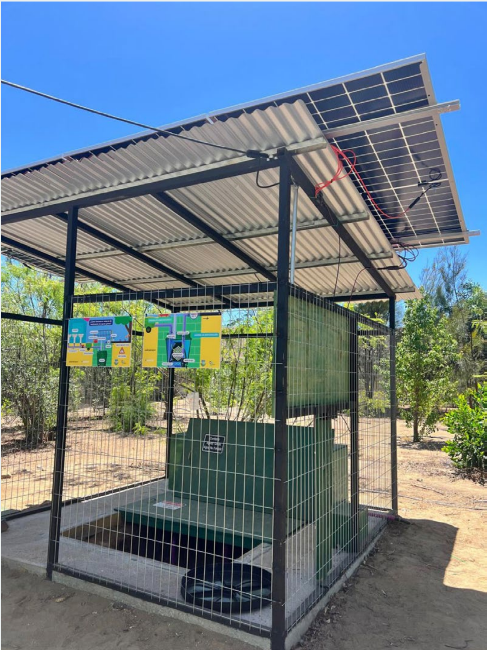
Bomba alimentada por paneles solares
