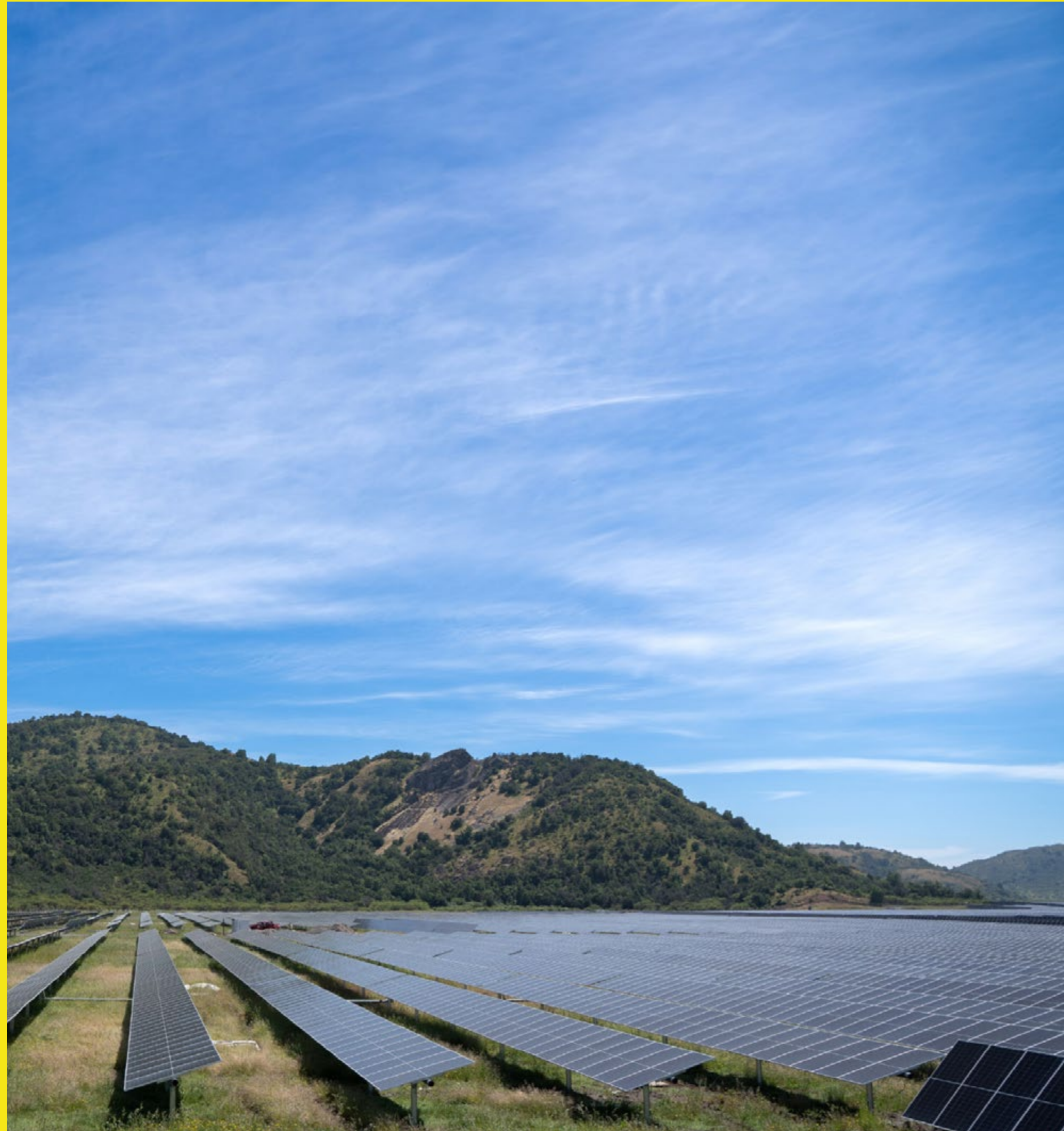
Gran Teno 200 MW PV plant, Chile
