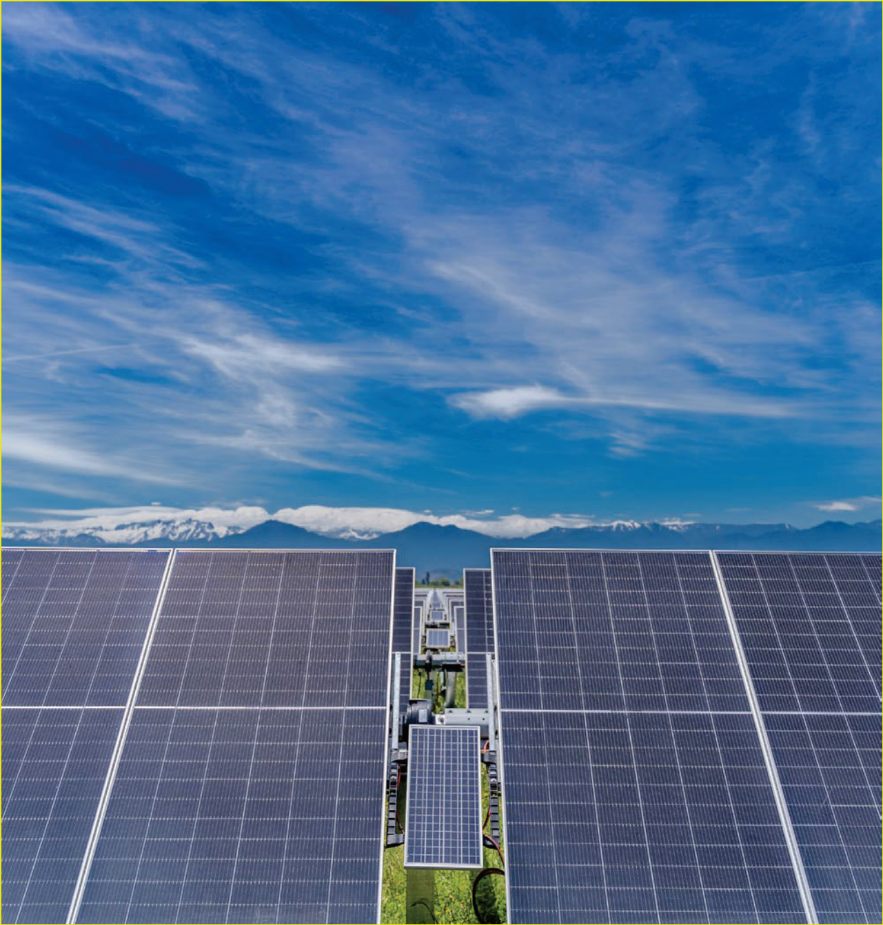
Planta FV Gran Teno 200 MW, Chile
