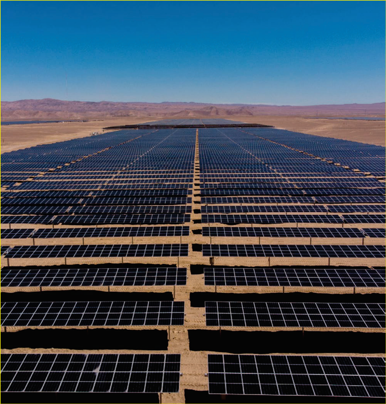
Planta FV Quillagua 103 MW, Chile
