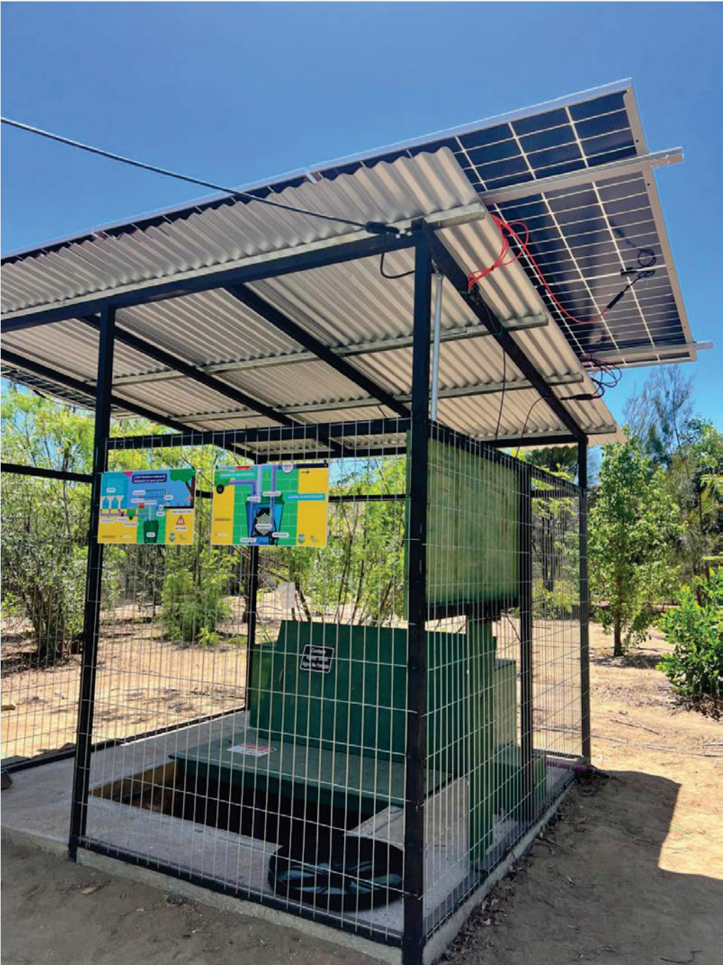
Bomba alimentada por paneles solares
